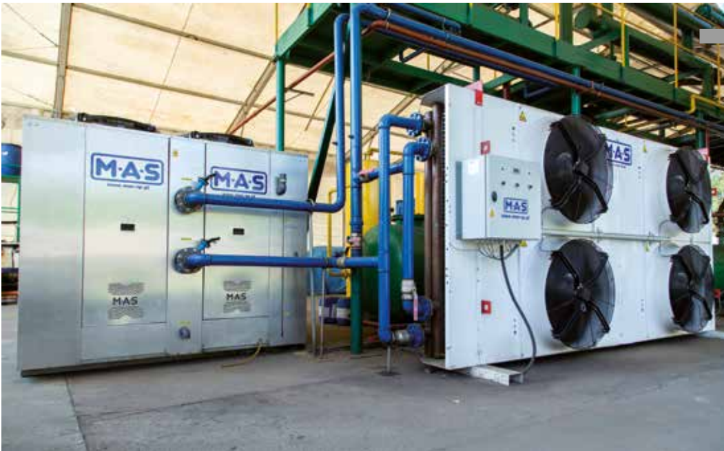
Intercooler i chiller – urządzenia do schładzania instalacji termolitycznej Intercooler and chiller devices for cooling for a thermal decomposition process carried out in the POLBLUME device in a specialized instalation.
