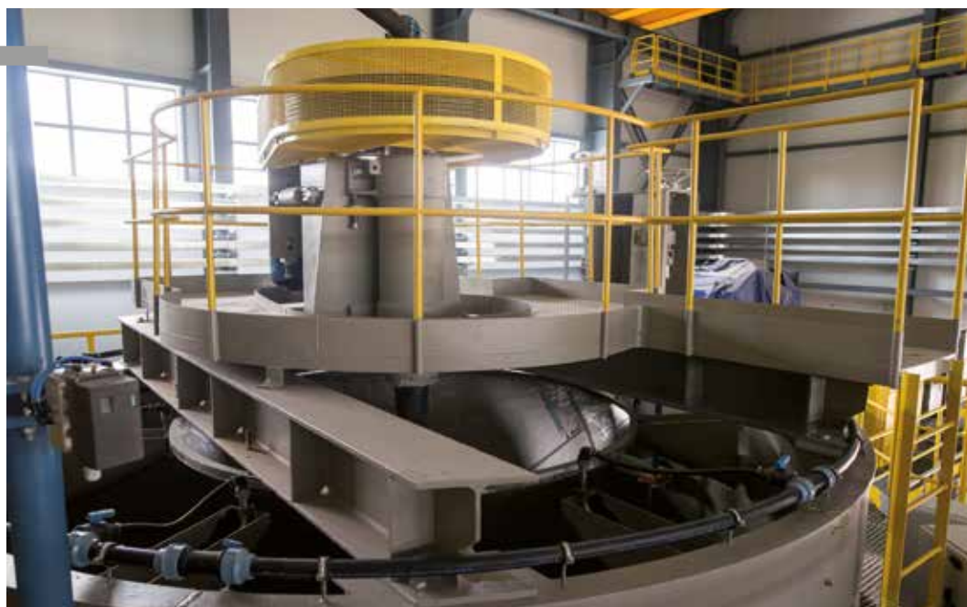
Hala Tlenków 02 i 03 – Instalacja do płukania i ługowania tlenku Waelza Waelz Oxide Washing and Leaching Plant
