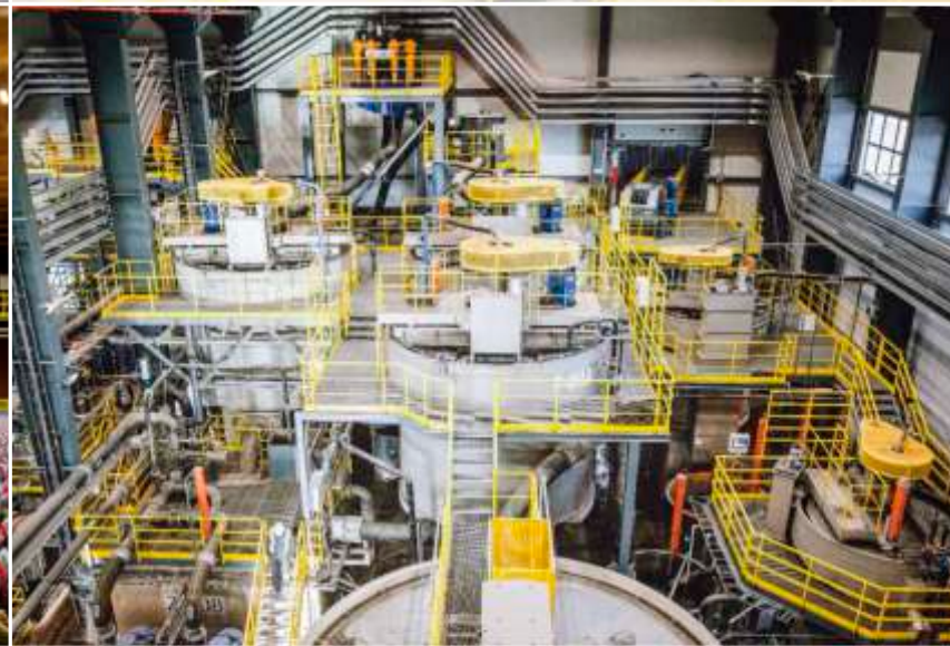
Nowa flotacja: zespół urządzeń flotacyjnych.
